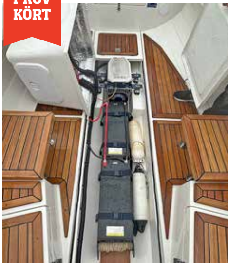
Hela den elektriska drivlinan i Långsjösnipan på 18 fot. Batterierna är monterade för om motorn.
